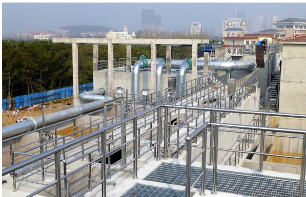
Biofiltrationsanlage einer chinesischen kommunalen Kläranlage.
