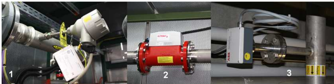
Abb. 3.18: Gasdurchflussmessungen: 1 = Thermische Messverfahren (Fa. Binder), 2 = oszillierendes Messverfahren (Fa. Esters), 3 = Staudrucksonde (Fa. ABB) (Bildquellen: Autor)
