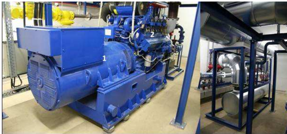
Abb. 8.10: Blockheizkraftwerk mit 537 kW el -Gasmotor: 1 = Generator, 2 = Gasmotor, 3 = Peripherie des Blockheizkraftwerkes mit Heizungsverteilung (Bildquellen: Autor)
