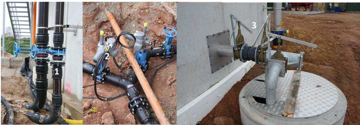
Abb. 4.2: Handschieber zum Notabsperren von Pumpleitungen (1), Schieber mit Elektroantrieb (2), Handschieber an einer Gärrestabgabestation (3) (Bildquellen: Autor)
