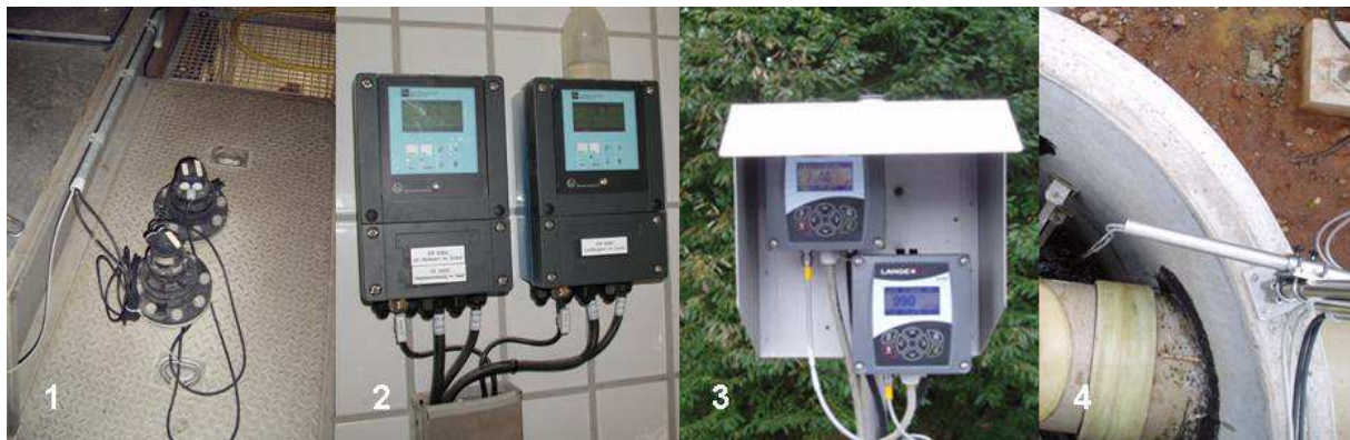
Abb. 3.19: pH, elektrolytische Leitfähigkeit und Temperatur in Ex-Schutz-Ausführung (1) mit Messumformern (2) in einem Rechengebäude (Fa. Endress+Hauser); pH, elektrolytische Leitfähigkeit und Temperatur in Freiluftanordnung (4) mit Messumformern (3) (Fa. Hach Lange) (Bildquellen: Autor)
