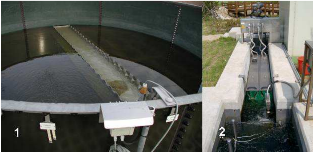
Abb. 5.12: Behandlung des Kläranlagenablaufs: Flächenfilter (1), UV-Desinfektion (2) (Bildquellen: Autor)
