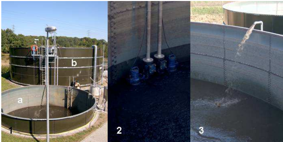
Abb. 5.13: Trübwasserspeicher (1a), Schlammstapelbehälter (1b), Tauchmotorpumpen zur gezielten Dosierung von Trübwasser in die Reaktoren (2, 3) (Bildquellen: Autor)
