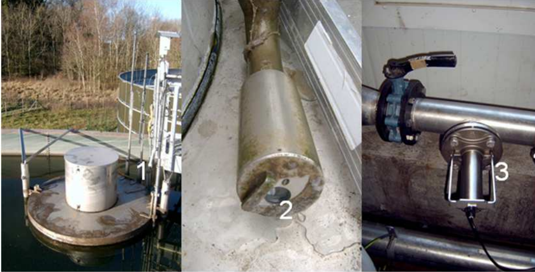
Abb. 3.34: Installation einer TS-Messsonde (Hersteller: Hach Lange) in einem SBR und in einer Übersschiessschlammleitung (1 = Befestigung der Sonde am schwimmenden Dekanter, 2 = Sonde mit optischen Fenster und Wischvorrichtung, 3 = TS-Sonde in einer ÜS-Leitung) (Bildquellen: Autor)
