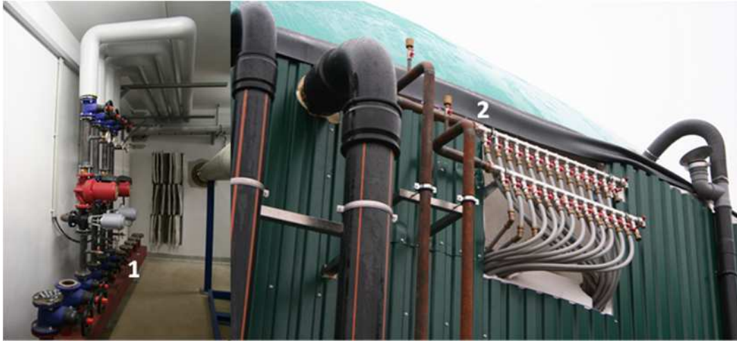
Abb. 4.4: Heizungssystem (1) im BHKW-Raum, Anschlüsse an die Heizung des Fermenters (noch vor der Verkleidung der Rohrleitungen und Anschlüsse) (Bildquellen: Autor)
