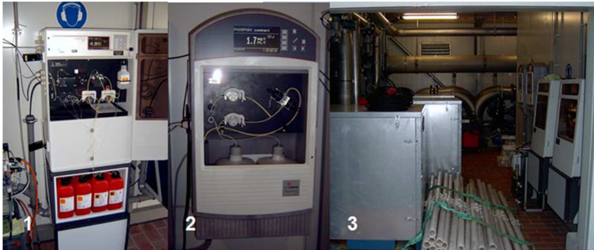
Abb. 3.4: Lösung für die Beprobung von zwei SB-Reaktoren mit je einem Satz Messgeräte: Ammonium- (1) und Phosphat-Prozessphotometer (2), Installation der Messgeräte in eine Einhausung zwischen den beiden Reaktoren (Bildquellen: Autor)
