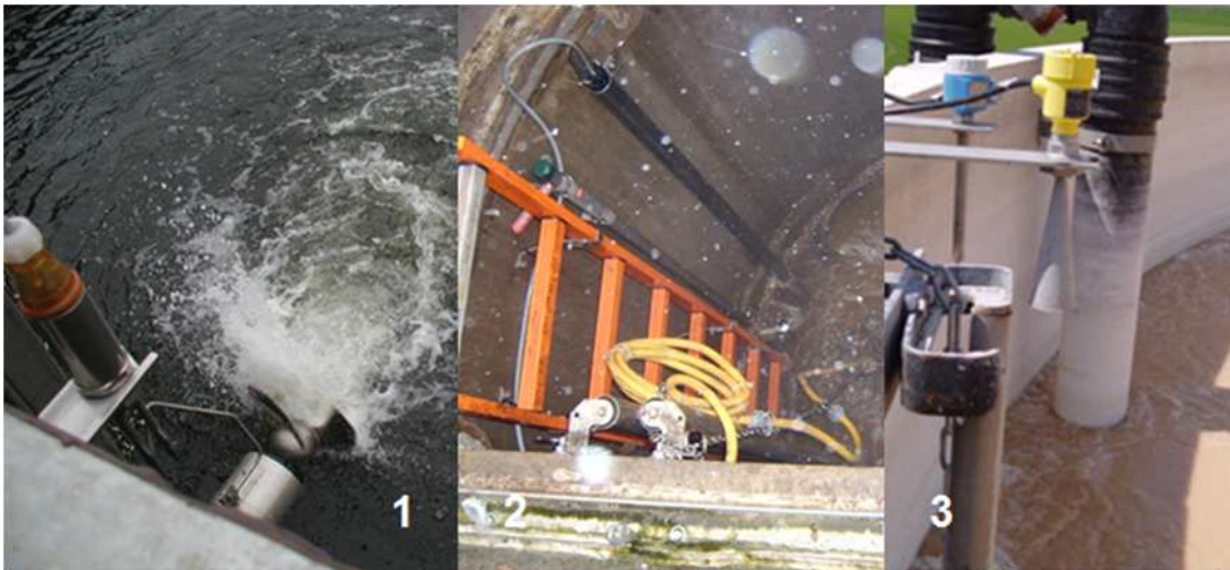
Abb. 3.22: Füllstandsmessungen auf Kläranlagen: 1 = Schwingsonden-Füllstandsschalter (Grenzfüllstand), 2 = hydrostatische Bodendruckmessung, 3 = Kombination aus Radarmessung (Fa. WEGA) und Grenzfüllstandsmessung (Fa. Endress+Hauser) (Bildquellen: Autor)
