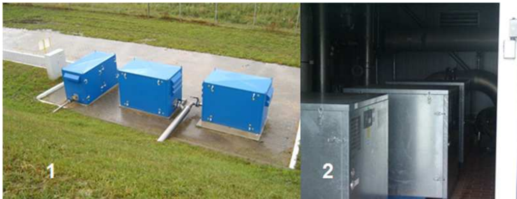
Abb. 5.9: Gebläse in Außenaufstellung (1), Gebläse (2) zwischen den beiden SB-Reaktoren witterungsgeschützt in einem Raum aufgestellt („Brillenform“) (Bildquellen: Autor)
