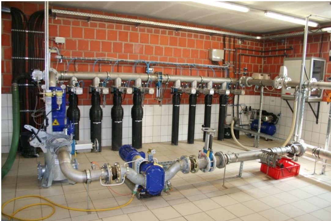
Abb. 10.5: Zentralisierte und voll-automatisierte Pumpstation (Bildquelle: Wiese und Kujawski [2007] )
