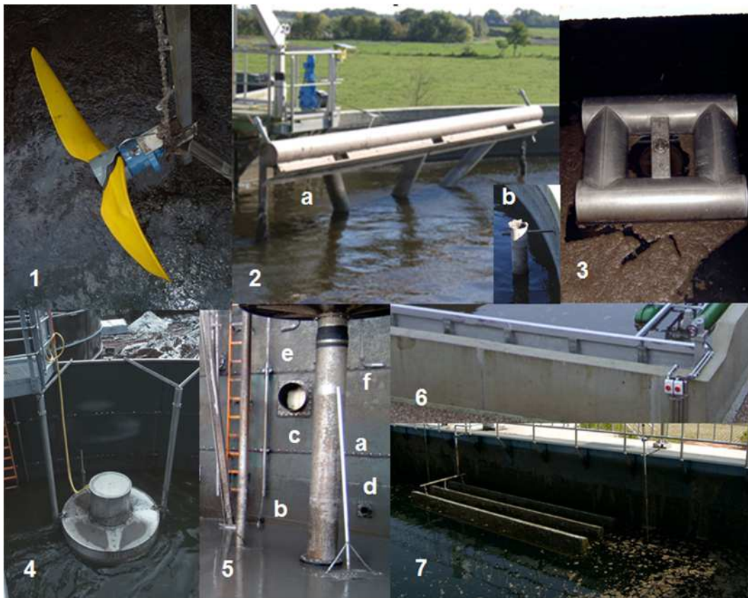
Abb. 5.10: Installationen in einen Reaktor: Großflügelrührwerk (1), Dekanter mit Seilzug (2a), Schwimmschlammabzug/ Notüberlauf (2b), schwimmender Dekanter mit offenem Ablaufrohr/-schlauch (3), schwimmender Dekanter mit Teleskopstab (4, 5a) durch die Beckensohle, sonst noch zu sehen: Füllstandsmessung (5b), Beckenzulauf (5c), Überschussschlammabzug (5d), Nitratsonde am Dekanter (5e), TS-Sonde am Dekanter (5f), absenkbare Wehrklappe (6), getauchte Ablaufrohre (7) (Bildquellen: Autor)
