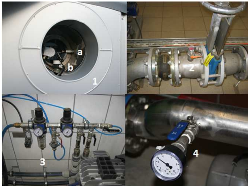
Abb. 3.15: Applikationen für Druckmessungen im Biogassektor: 1 = Schauglas eines Fermenters mit installierten Drucksensor (1a) (Über-/Unterdruck zwecks Gasraumüberwachung, Fa. WIKA) und Grenzfüllstandsmessung (1b) (Fa. Endress+Hauser), 2 = Drucküberwachung nach einer Drehkolbenpumpe, 3 = Druckluftstation zur Versorgung pneumatischer Schieber einer zentralen Pumpstation, 4 = analoge Druckmessung in einer Brauchwasserleitung (Bildquellen: Autor)
