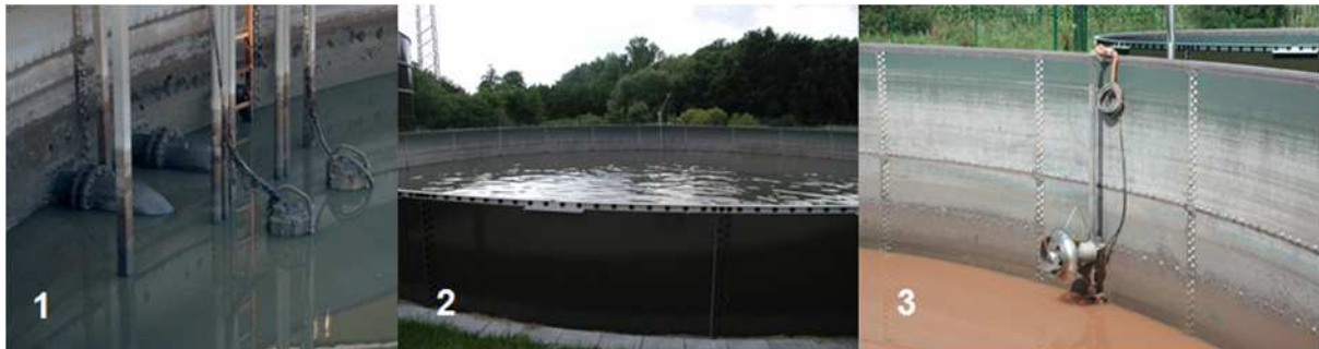
Abb. 5.6: Zwischenpumpwerke mit zwei Tauchmotorpumpen (1) integriert in einen Vorlagebehälter (2) mit einem schnell laufenden Tauchmotorrührwerk (3) (Bildquellen: Autor)
