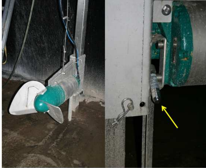
Abb. 10.22: Tauchmotorrührwerk mit einer Niveaumessung auf Basis eines einfachen Drucksensors (Wiese und König [2009C])
