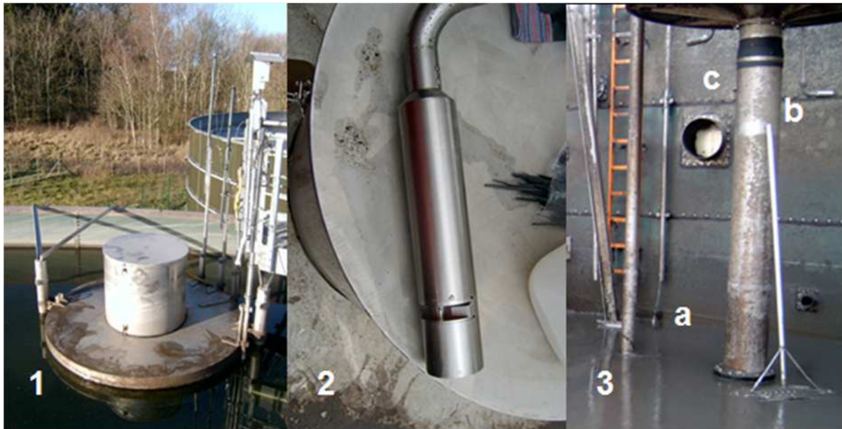
Abb. 3.25: Installation einer Nitratmesssonde ( Hach Lange [2001B] ) in einem SBR (1 = Befestigung der Sonde an einer schwimmenden Klarwasserabzugseinrichtung, 2 = Ziehen der Sonde für Reinigungsarbeiten, 3 = Dekanter im entleerten Zustand: a = Pegelsonde, b = TS-Sonde, c = Nitratsonde) (Bildquellen: Autor)
