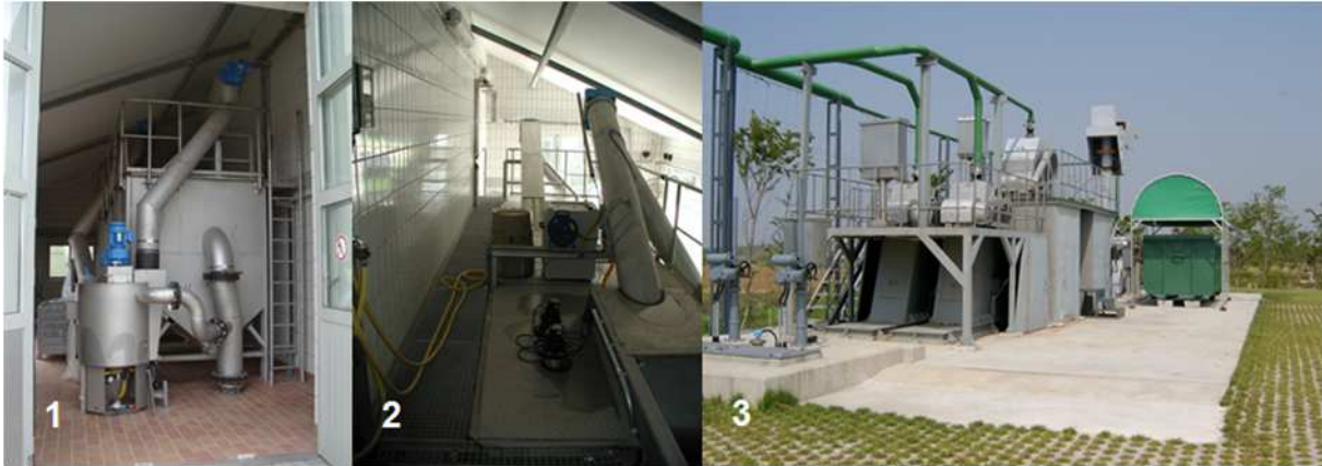
Abb. 5.5: Bilder mechanischer Vorreinigungssysteme auf SBR-Anlagen: aufgeständertes, eingehautes Kombimodul (1, 2) mit Notüberlauf, Spiralsieb, belüfteten Langsandfang mit Fettkammer und Sandwäscher; Einlaufauwerk in Außenaufstellung mit zwei Grobrechen, zwei Feinrechen und Sandfang (3) (Bildquellen: Autor)
