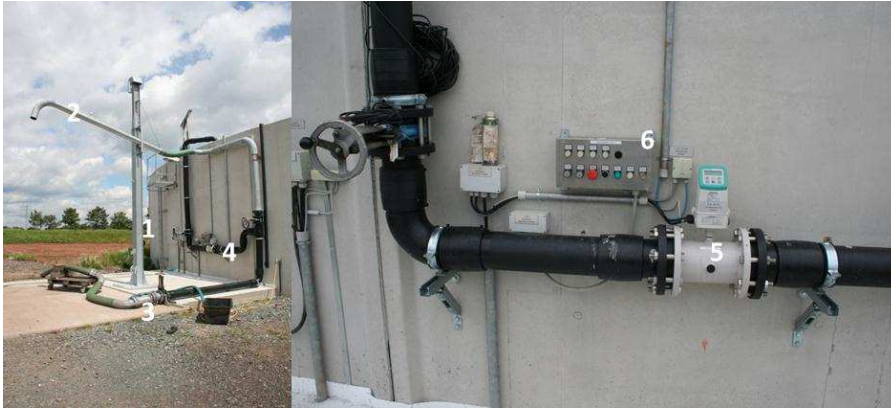
Abb. 8.9: Gärrestabgabestation an einem Gärrestlager (1) mit wahlweiser Abgabe an von oben (2) oder von unten zu füllende Güllefässer (3), Durchflussmessung zur Bestimmung des abgegebenen Gärrestvolumens (4, 5) und Bedienstation für Vorwahl verschiedener Güllefassgrößen bzw. verschiedener Gärrestabnehmer (6) (Bildquellen: Autor)
