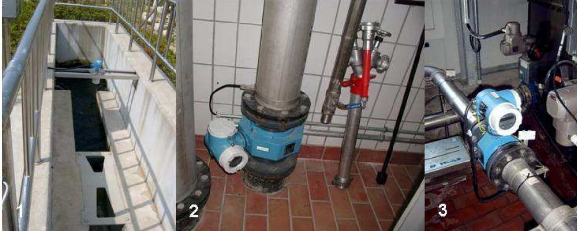
Abb. 3.16: Durchflussmesseinrichtungen auf Kläranlagen: Ultraschall-Messung mit Venturi-Messwehr im Kläranlagenablauf (1), MID-Messung (Promag, Fa. Endress+Hauser) im Kläranlagenzulauf (2), MID-Messung (Promag, Fa. Endress+Hauser) in der Überschussschlammleitung (3) (Bildquellen: Autor)
