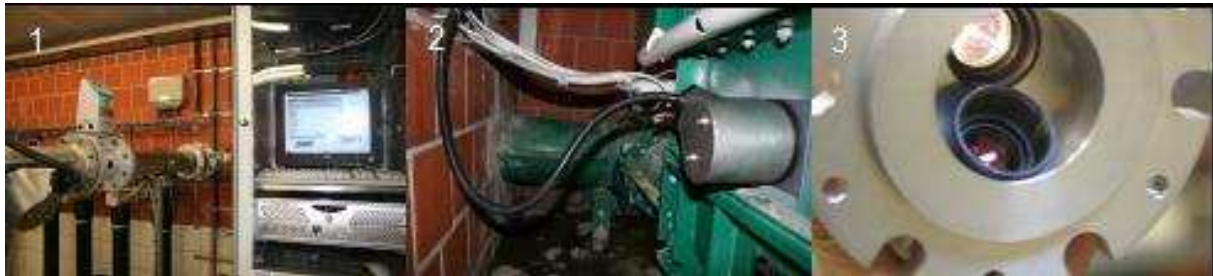
Abb. 10.11: Zentrale Pumpstation mit Nah-Infrarot-Spektrometer (1), NIRS Sensor am Feststoffdosierer (2), NIRS Sensor vor Installation (Bildquelle: Wiese et al. [2008A] )
