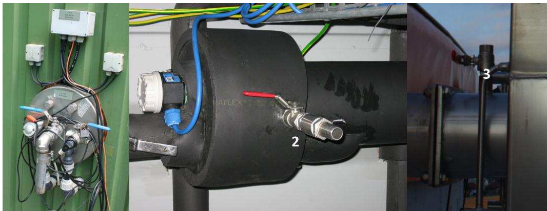
Abb. 4.5: Probenahmestutzen - flüssig (1), Probenahmestutzen - Biogas (2), Spülanschluss (3) (Bildquellen: Autor)
