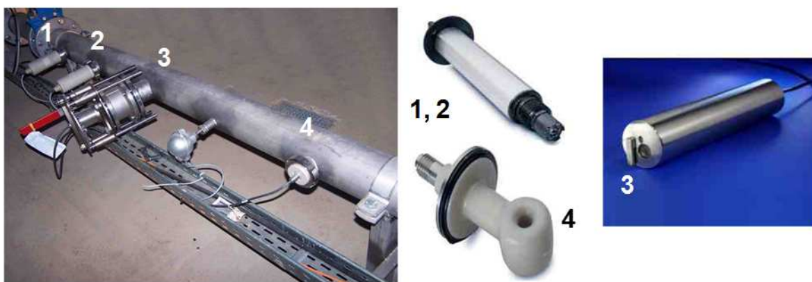
Abb. 3.29: Rohrleitung in einer zentralen Pumpstation einer Biogasanlage mit Einbauarmaturen für pH-Elektroden (1) und Redox-Elektroden (2), TS-Sonde (3) und Leitfähigkeitsmessung (4) (Messgeräte der Fa. Hach Lange) (Bildquellen: Autor und Fa. Hach Lange)
