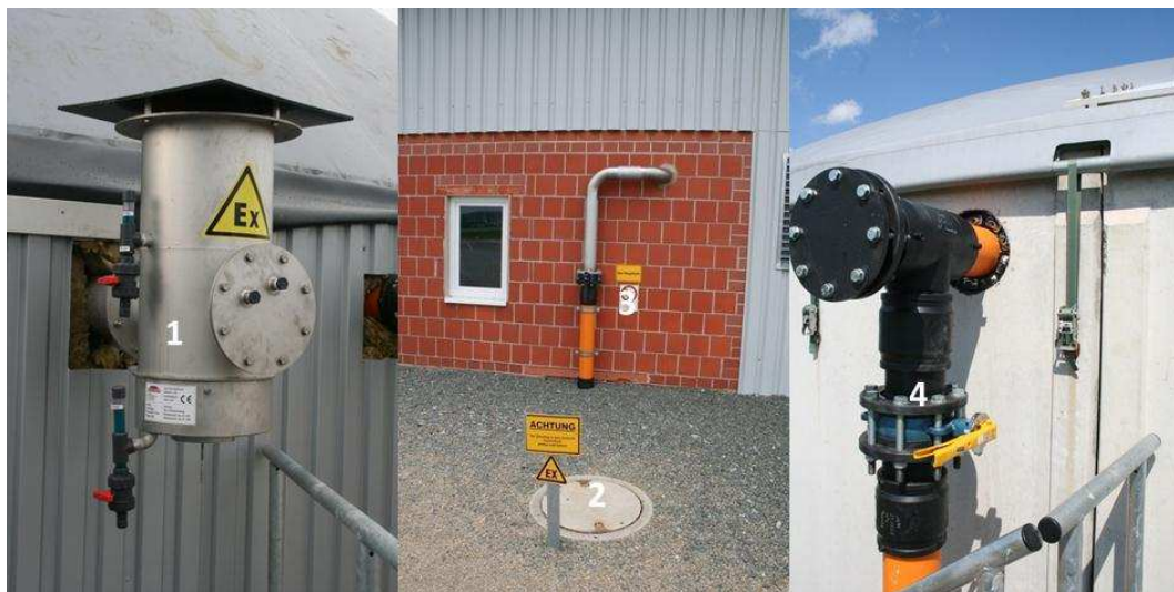
Abb. 4.6: Überdruck-/Unterdrucksicherung (1), Kondensatschacht (2), Notabsperrrhahn für Gasleitung (3), Gasabsperrschieber an einem gasdichten Gärrestlager (4) (Bildquellen: Autor)
