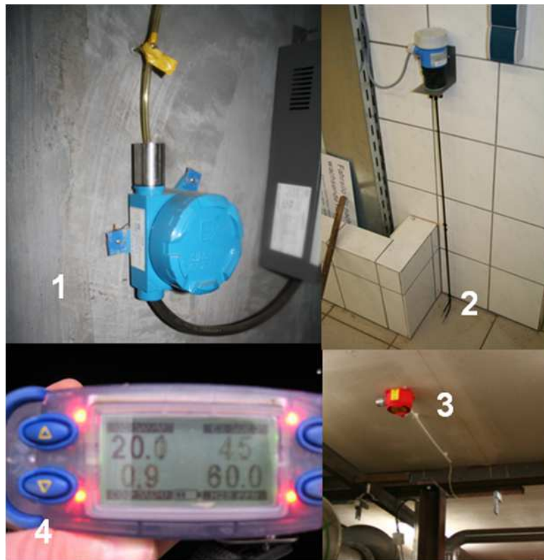
Abb. 9.4: Gaswarntechnik: 1 = stationärer Gaswarnsensor zur Detektion explosibler Gase in der Abluft eines Tragsluftdachs, 2 = Grenzfüllstandsmessung als Leckagesensor in einer zentralen Pumpstation, 3 = stationärer Gaswarnsensor zur Detektion explosibler Gase unter der Decke eines BHKW-Raum (Bildquellen: Autor)
