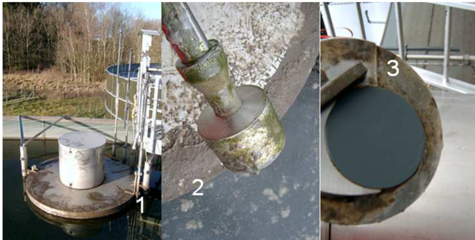
Abb. 3.32: Installation einer Schlammspiegelsonde (Fa. Hach Lange) in einem SBR (1 = Befestigung am schwimmenden Dekanter, 2 = Ziehen der Sonde für Reinigungsarbeiten, 3 = Sondenunterseite mit Fenster und Wischvorrichtung) (Bildquellen: Autor)
