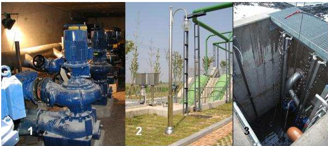
Abb. 5.4: Diverse Typen von Pumpwerken: Trocken aufgestellte Kreiselpumpen (1), gekapseltes Schneckenhebewerk (2), Tauchmotorpumpen (3) (Bildquellen: Autor)
