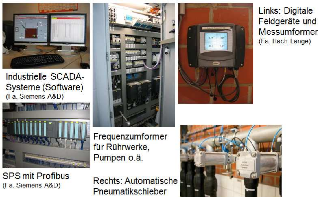
Abb. 9.2: Exemplarische Darstellung von Standardkomponenten aus der Anlagenautomation, die auch auf Biogasanlagen zum Einsatz kommen (Bildquellen: Autor)
