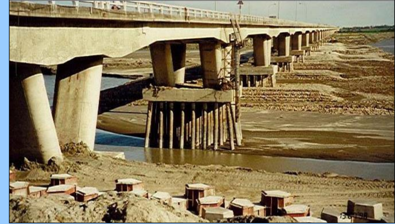
Abb.1: Beispiel für Auskolkungen an Brückenpfeilern (Melville & Coleman, 2000)
