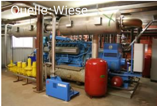
wärmegeführte Gas- & Zündstrahl-Motoren
